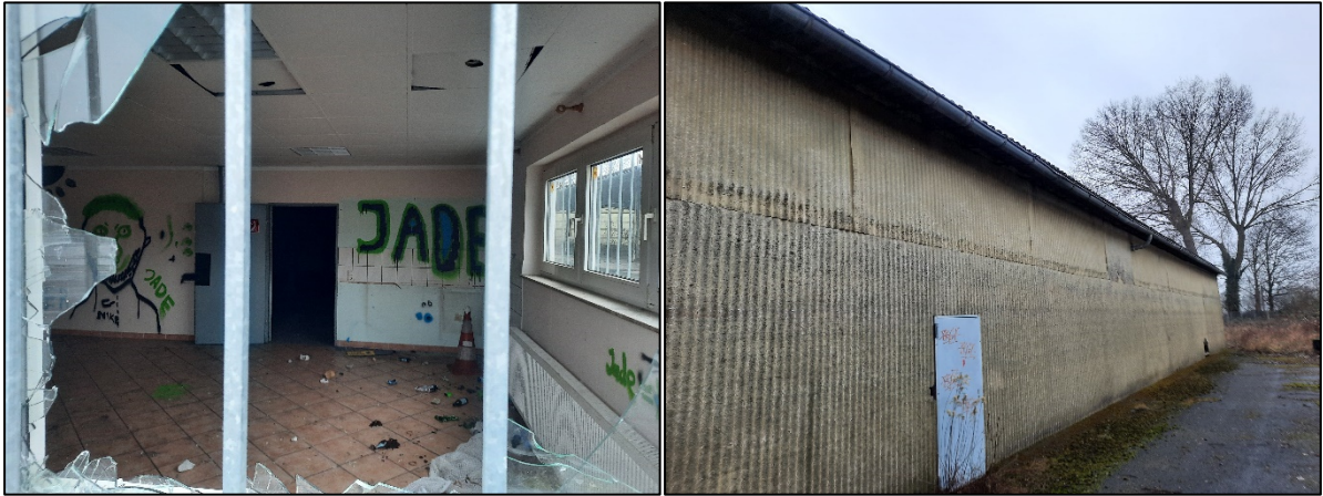
Abbildung 11: Blick in den geschlossenen Teil der Halle (links) sowie ein Blick auf die Außenwände der Halle (rechts).
