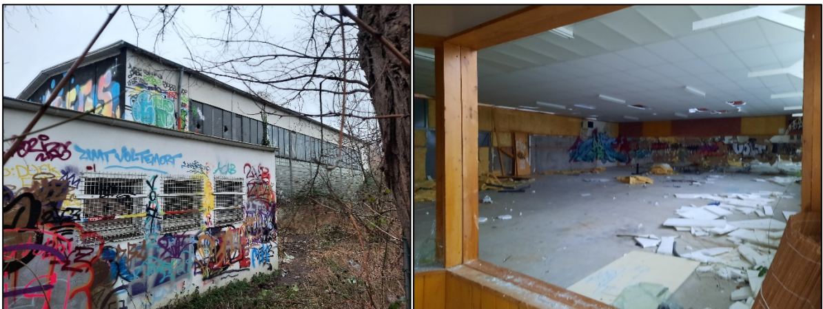
Abbildung 8: Die ehemalige Sporthalle (links) mit Blick hinein durch ein eingeworfenes Fenster (rechts).
