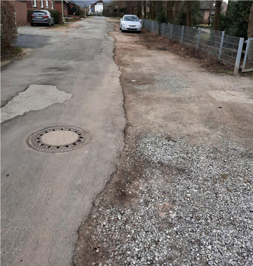
Straßenzustand Auf der Klause angrenzend an Friedhof
