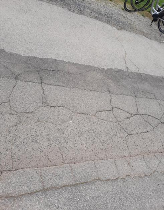
Straßenschäden Auf der Klause
