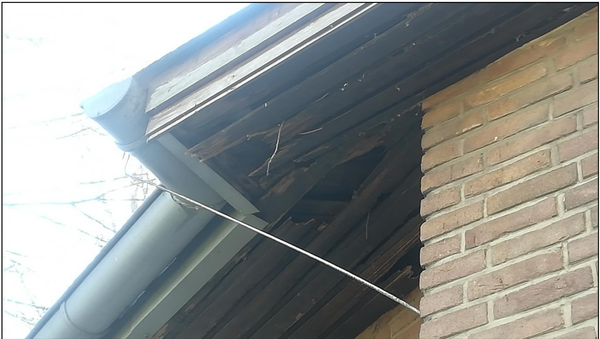
Abb. 9: Beschädigungen im Dachbereich des ehemaligen Toilettengebäudes.
