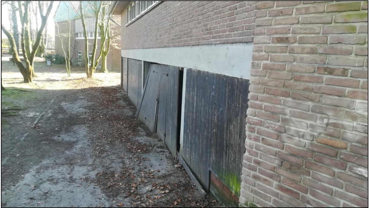
Abb. 8: Nordöstliche Fassade des Toilettengebäudes mit Holztoren mit Beschädigungen.
