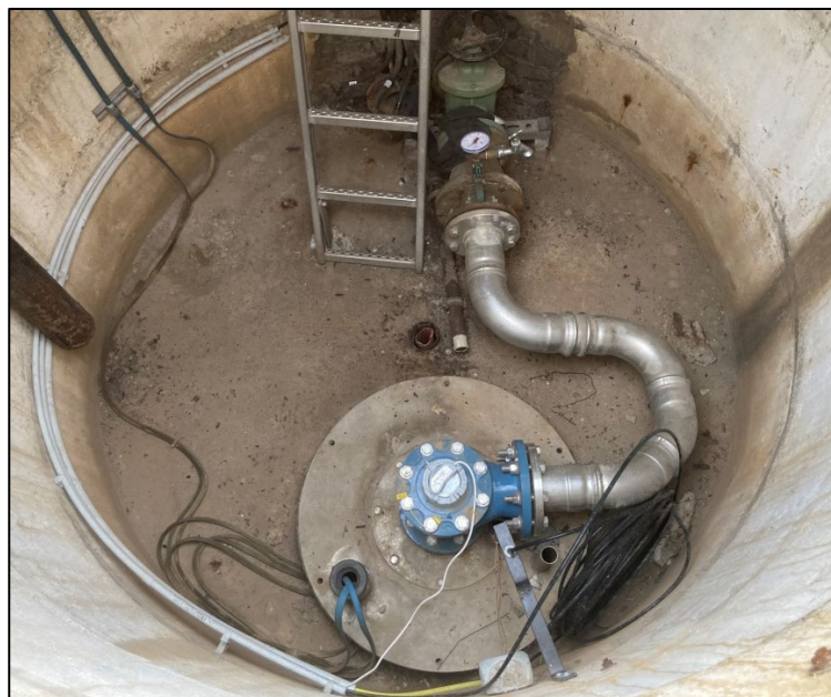
Abb. 2: Brauchwasserbrunnen I, Walterscheid GmbH
