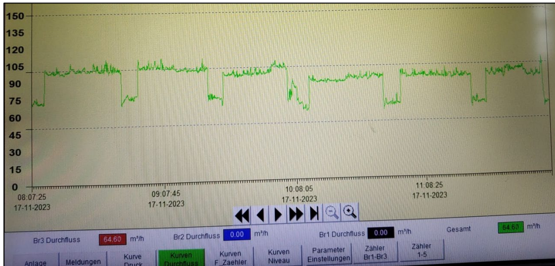
Abb. 9: Display Fernwirktechnik im Kesselhaus: Ganglinie Förderrate Br. III
