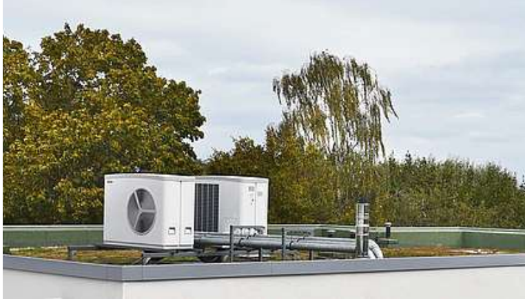
Abbildung 3: Platzierung der Lüftereinheiten aufs Dach
